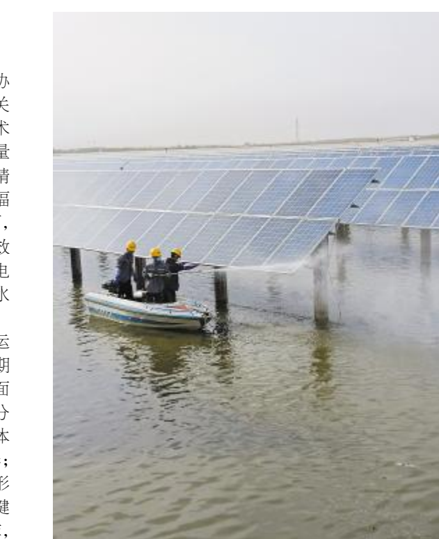
通威宁夏贺兰“渔光一体”电站运维团队清洗组件
